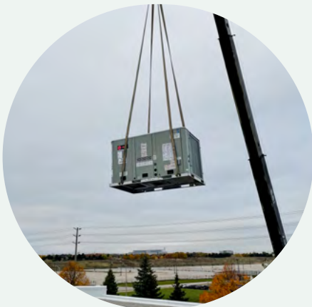
Unité électrique sur le toit au 1925, promenade Williams
